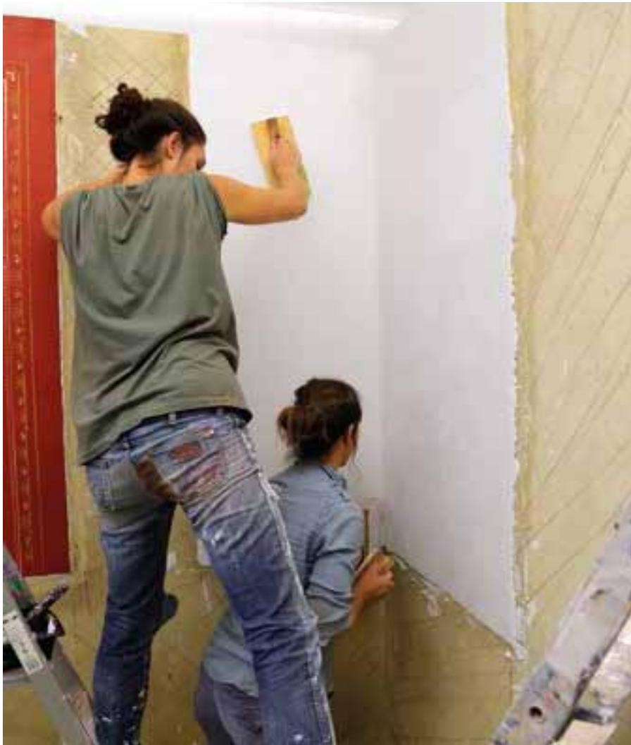
Application à la taloche de la troisième couche d'enduit de chaux et de poudre de marbre. (© Benjamin Coulon)
