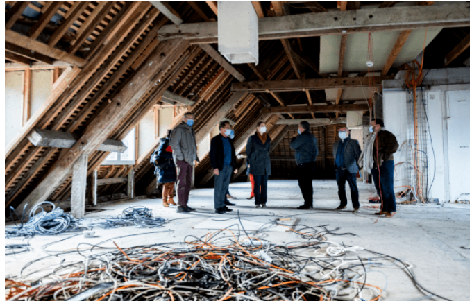
Visite du chantier de rénovation du grand hôtel @ Préfecture de la Creuse
